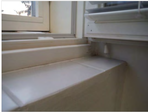
Kuva 59. Uuden luokkaikkunan listoituksen liittymä ikkunapenkkiin, listan päässä maalivaurio
