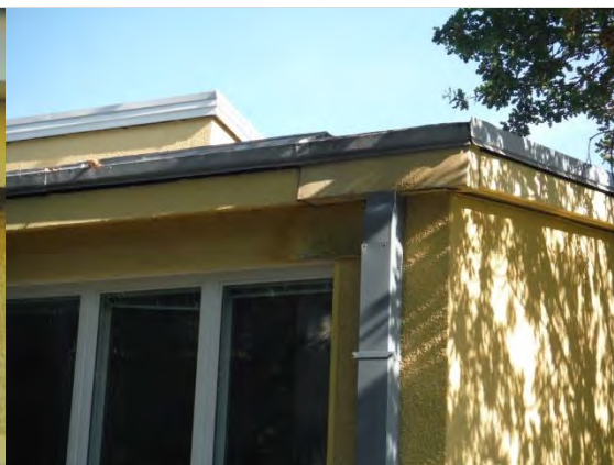
Kuva 22. Vuotava vesikouru tilan 2001 nurkalla
