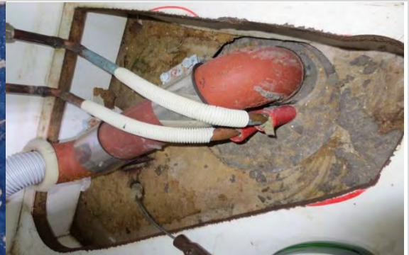
Kuva 48. Välipohjaan vuotavia luokan allaskaapin putkiliitoksia.
