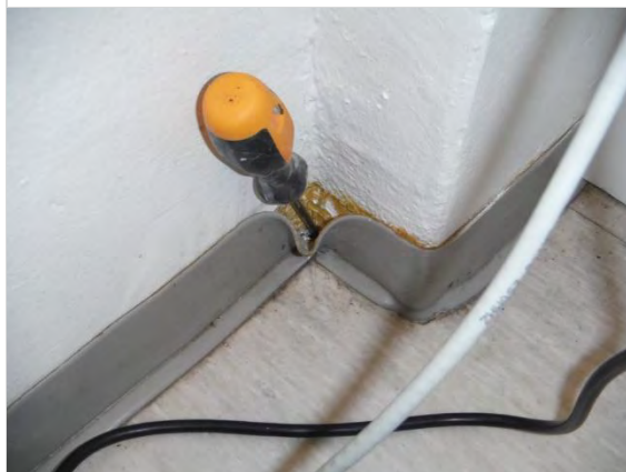
Kuva 11. US/AP liittymä ei ole tiivis luokkatilassa. Liittymän kautta ilmavirtausta sisätiloihin
