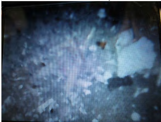
Kuva 43. Juhlasalin joustolattian alla rakennusjätettä, sanomalehteä ymv.
