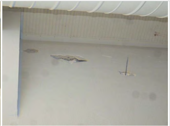
Kuva 26. Luokan 3026 (14) ulkoseinässä "korkanneita" kohtia.
