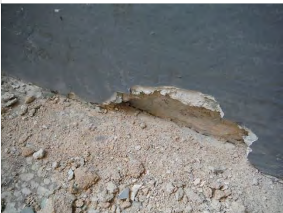
Kuva 12. AP/väliseinä liittymä käytävätilassa ei ole tiivis. Liittymän kautta ilmavirtausta sisätiloihin.
