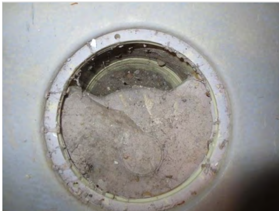
Kuva 63. Kuivunut lattiakaivo, josta viemärikaasut pääsevät sisätilaan. Harvemmin käytetyt kaivot täytetään säännönmukaisesti.
