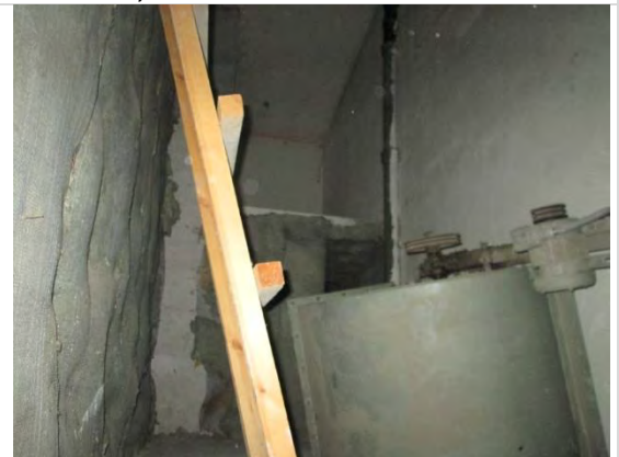
Kuva 78. Näkymä varaston 3024 yläpuolella olevaan IV-konehuoneeseen(ei käytössä oleva)
