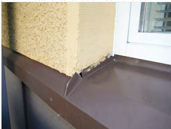
Kuva 24. Uuden vesipellin liittymä ikkuna-aukossa ei ole vesitiivis
