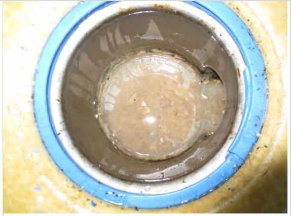
Kuva 62. Kotitalousluokan lattiakaivo panttaa. Kaivo on huuhteltava puhtaalla kuumalla vedellä joka päivä rasvan kerääntymisen estämiseksi.
