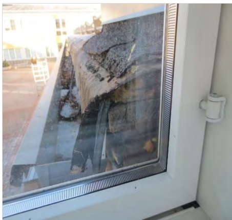
Kuva 29. Säälle alttiina olevia vesikaton puisia alusrakenteita.
