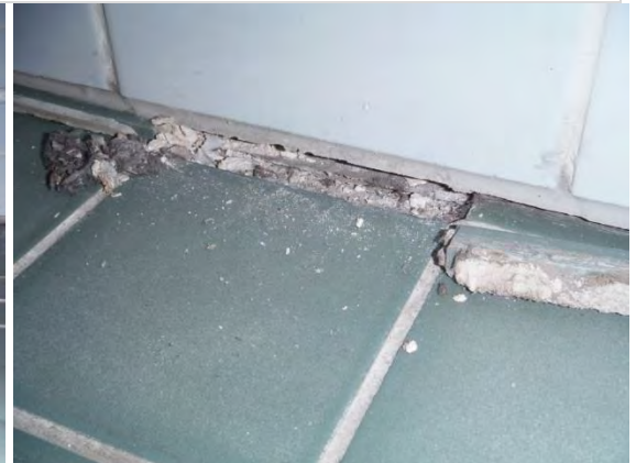
Kuva.76 Lähikuva edellisestä kohtaa. Rakenteessa ei ole vesieristystä.
