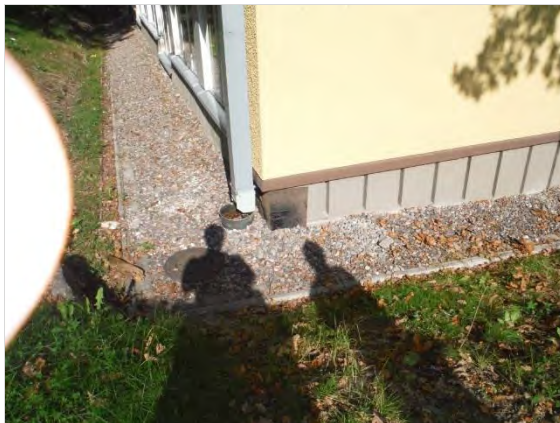
Kuva 1. Länsisivun nurkka. Maasto viettää rakennukseen päin. Erotuskaistan ja nurmialueen välissä oleva betonikouru ja kaivot ovat lehtiä täynnä.
