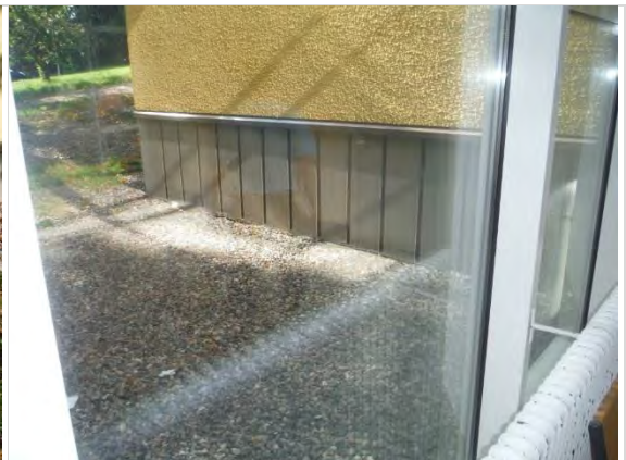
Kuva 2. Länsisiiven ja hallintosiiven väliin jää "pussi" johon kerääntynyt lunta ja pintavettä.
