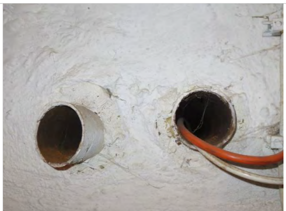
Kuva 72. Käyttämättömiä putkia, joiden kautta ilmayhteys sisätilaan. Poistettava tai tukittava.
