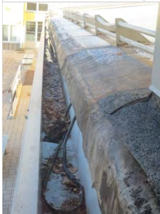
Kuva 39. Puiden lehtiä lähes täynnä oleva räystäskouru.
