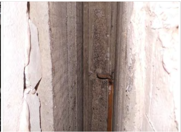
Kuva 52. Näkymä painovoimaisen ilmanvaihdon kanavaan venttiilin kautta
