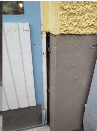
Kuva 56. Puutteita metallirakenteisen oven liittymä seinärakenteeseen lämmöneristyksen ja listoituksen osalta.
