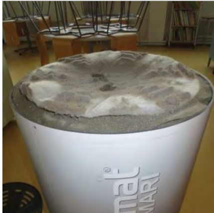
Kuva 61. Kotitalousluokassa oleva ilmanpuhdistin huoltamaton.
