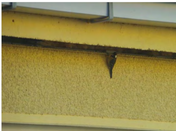
Kuva 21. Uuden julkisivuverhouksen ja vanhan rakenteen välistä puuttuu lintu- ja jyrsijäverkot.
