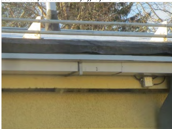
Kuva 23. Julkisivuremontissa tehty ulkoseinien läpimenoreiät tiivistämättä.
