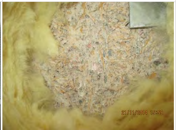
Kuva 28. Toja-levyn pintaa ei ole tasoitettu työselityksen mukaisesti
