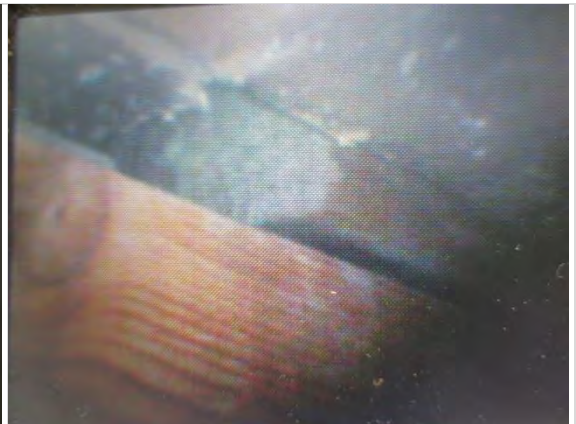
Kuva 54. Puutteita ikkunan viereisen kevyen seinärakenteen lämmöneristyksessä.
