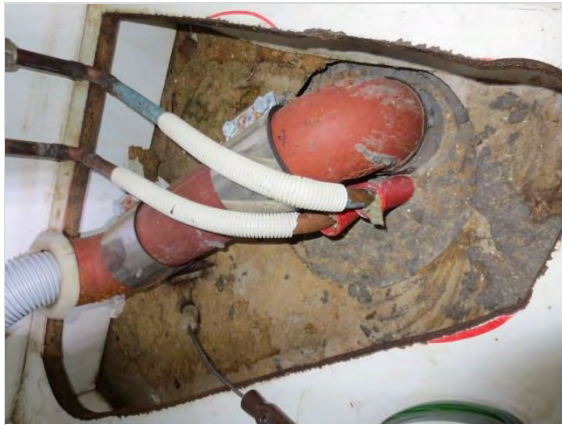
Kuva 73. Allaskaappien putkivuodot. Putkivuodot korjattava ja huonokuntoiset allaskaapit vaihdettava.
