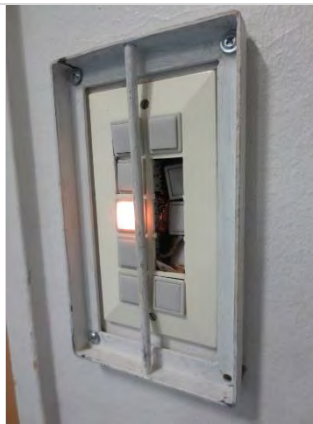
Kuva 64. Juhla/liikuntasalissa on rikkiäinen turvallisuutta vaarantava valokatkaisija. Korjattava.
