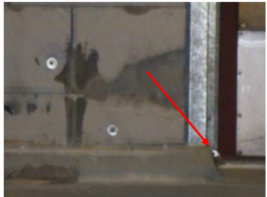
Kuva 38. IV-konehuoneen oviaukon viereisen julkisivun reiän kautta pääsee kosteutta alla oleviin rakenteisiin.
