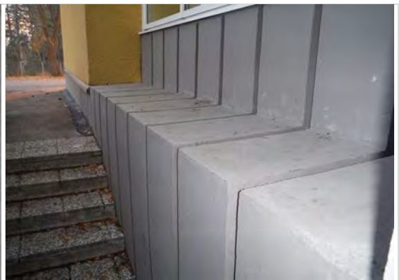
Kuva 4. Tilan 1091 kohdalla oleva sokkelin patti, jossa on purkamatonta muottilaudoitusta
