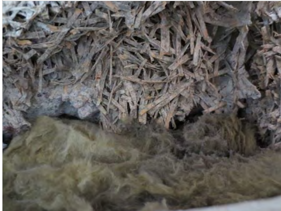
Kuva 33. IV-läpiviennin paljaita mineraalivilloja käytävän läpiviennissä.
