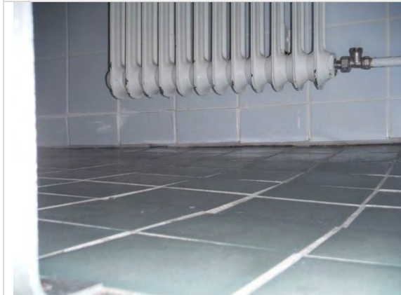
Kuva 75. Hallintosiiven opettajien WC-tilojen alapohjalaatta on painunut, lattia/seinä nurkan silikoni-sauma on auki.
