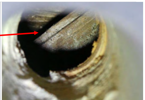
Kuva 6. Avauksesta näkyy mikrobivaurioituneita purkamattomia muottilautoja.
