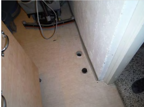
Kuva 45. Vanhat sulkemattomat läpiviennit välipohjassa, alla kellarikerros
