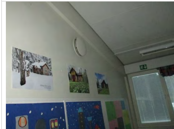
Kuva 77. Avonainen painovoimaisen ilmanvaihtojärjestelmän venttiili luokkatilassa
