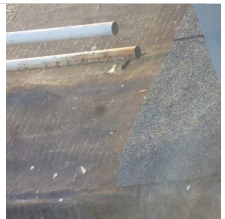
Kuva 30. Huonokuntoista paikoin korjattua vesikattetta.
