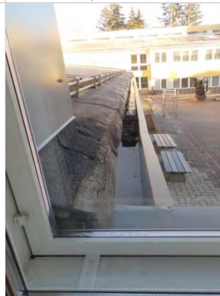
Kuva 40. Vettä lähes täynnä oleva räystäskouru.
