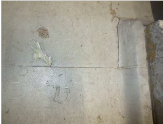
Kuva 41. Hitsaamattomia muovimattoja IV-tiloissa.
