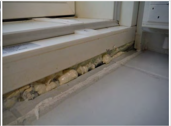
Kuva 60. Edellisen kuvan lista irrotettu. Vaahtotiivistys on puutteellinen.
