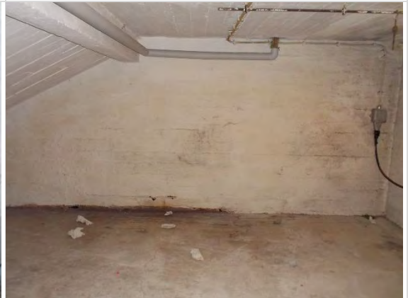
Kuva 20. Tilan 1089 sisäpinnan rakenteita, näkyvää mikrobikasvua pinnoilla
