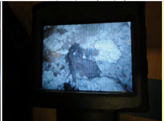
Kuva 44. Voimistelusalin puulattian alla epäpuhtauksia
