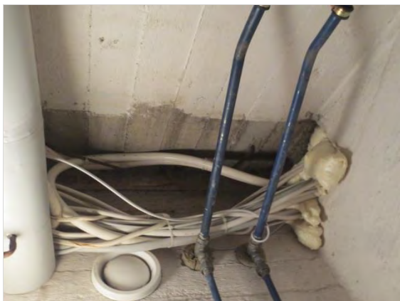
Kuva 71. Osastoivien rakenteiden läpiviennit eivät ole tiiviitä alakattotiloissa. Läpiviennit on korjattava niin, että palomääräykset täyttyvät.
