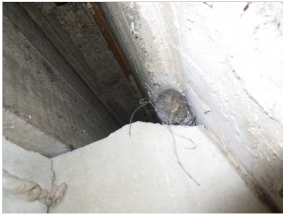
Kuva 67. Vanhoja käytössä olevia painovoimaisen ilmanvaihdon kanavistoja.
