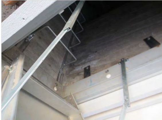
Kuva 49. IV-konehuoneen nousukuilun kosteusvaurioita välipohjarakenteessa.
