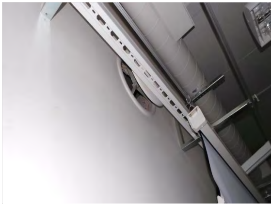
Kuva 51. Luokkatilassa avoin painovoimaisen ilmanvaihdon poistokanava.
