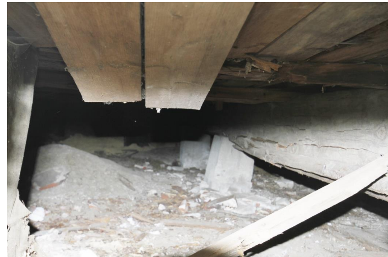
Kuva 62. Alapohjan ryömintätila kuvattuna luoteispäädyn tuuletusaukosta. Alapohjan kantavia palkkeja tukevat betonipilarit ovat painuneet ja vinossa. Kuva: FCG, 2023.
