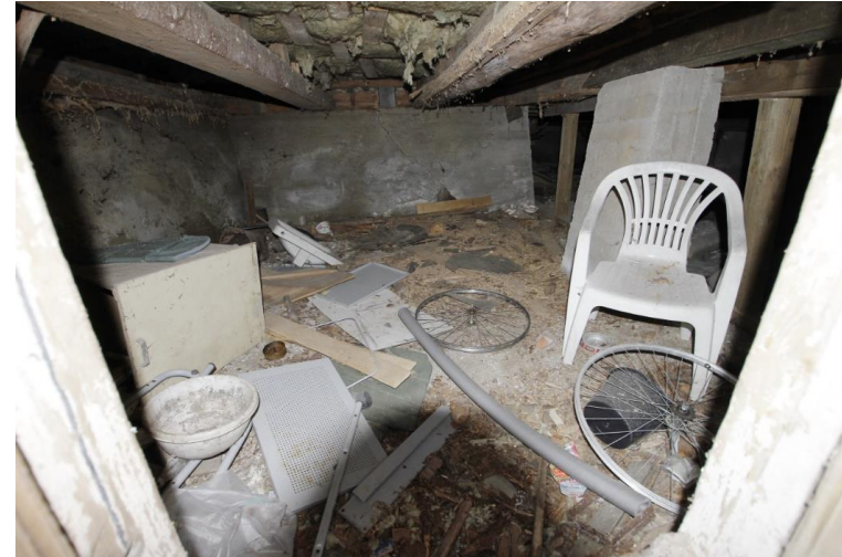
Kuva 61: Alapohjan ryömintätilaa on käytetty tavaroiden varastointiin, mikä voi heikentää sen tuulettumista. Orgaaninen aines, kuten rakennusjäte ryömintätilassa voi altistaa haitallisille määrille mikrobikasvustoa. Kuva: FCG, 2023.
