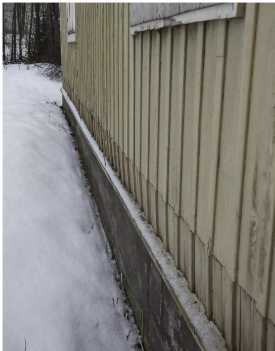
Kuva 45 (vasemmalla). Julkisivuvuoraus on jouduttu avaamaan seinien alareunassa. Seinärakenteiden painuminen näkyy julkisivun pullistumisena.
