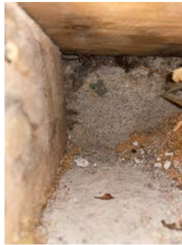
Kuva 26. B- ja C-osien välipohjat eivät ole yhteydessä toisiinsa. Kuva välioiven kohdalta C-osalta B-osalle päin
