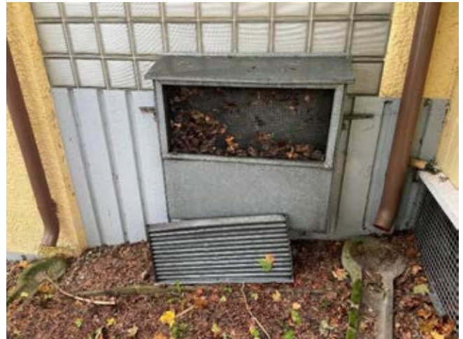
Kuva 55. Raitisilmanoton säleikön takana oli verkko, joka esti suurempien roskien pääsyn raitisilmakammioon. Kammioon kuitenkin tihkutti vettä pellitysten liitoksista.
