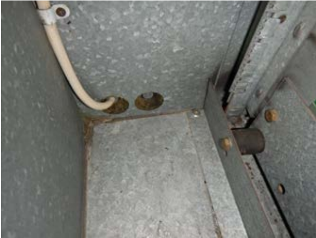
Kuva 62. Paljasta mineraalivillaa TK-1 puhallinkammion sähköläpivienneissä
