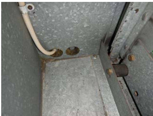
Kuva 85. TK-1 puhallinkammion sähköläpivienneissä paljasta mineraalivillaa
