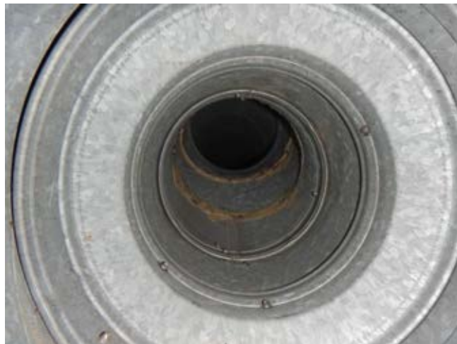
Kuva 71. TK-1 tuloilman runkokanava. Kanavassa vähäinen määrä irtoroskaa
