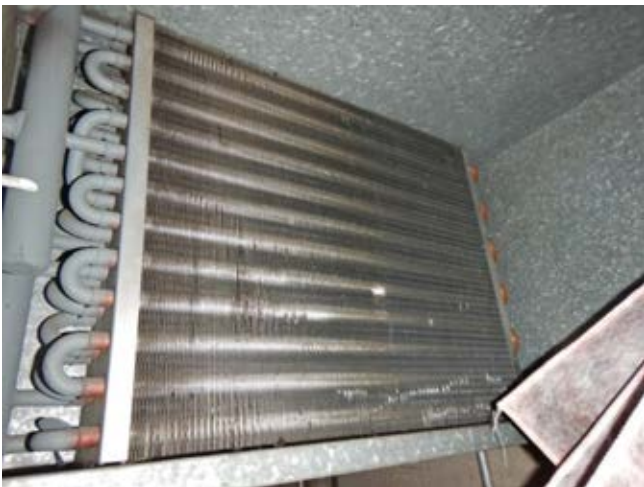
Kuva 64. TK-2 lämmityspatteri oli puhdas
