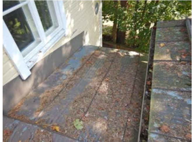
Kuva 32. Porrashuoneen kohdalla rakennusosien liitoksessa vesikatto on matalammalla tasolla.
