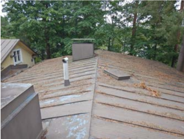
Kuva 31. Maalipinnan vaurioita rivipeltikatteessa, katossa kulkuluukku yläpohjaan
