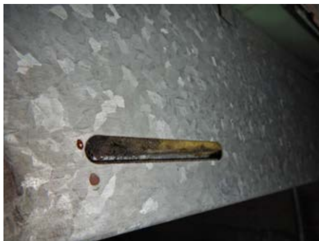
Kuva 86. TK-2 puhallinkammion luukun salpojen urissa paljasta mineraalivillaa
