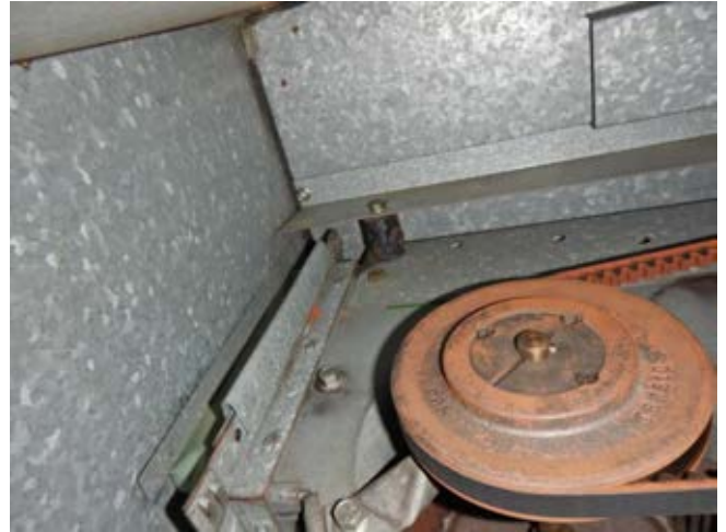
Kuva 67. TK-2 puhaltimessa ruostetta. Puhaltimen vaimenninkumit ovat hapertuneet
