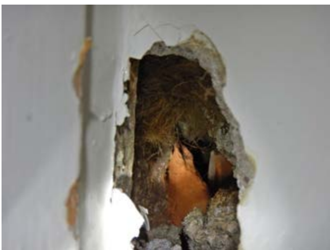
Kuva 21. Ikkunoiden pystykarmin ja ulkoseinän liitoksessa on pellavarivetilke. Karmin liitoksesta oli suora yhteys ulkoseinä mineraalivillaeristekerrokseen
