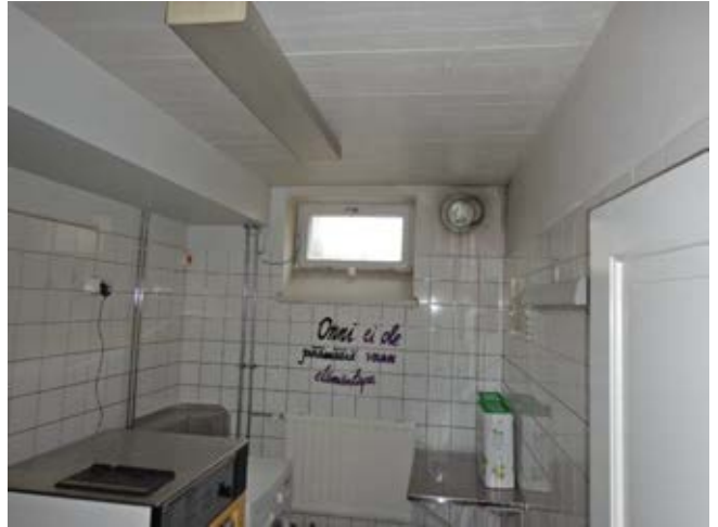
Kuva 47. kellarin takkahuoneessa ja pyykki/pesutiloissa sekä varastosa on painovoimaiset tuloilmaventtiilit ulkoseinissä
