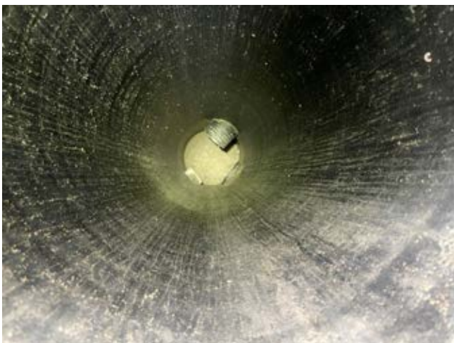
Kuva 3. Kaakkoisnurkalla takapihan puolella oleva salaojakaivo oli kuiva, putkistojen korkoasema selvästi alapohjarakenteen alapuolella.
