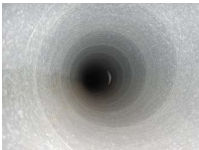
Kuva 81. Pölykertymää 1. kerroksen käytävän TK-1 runkokaanavassa
