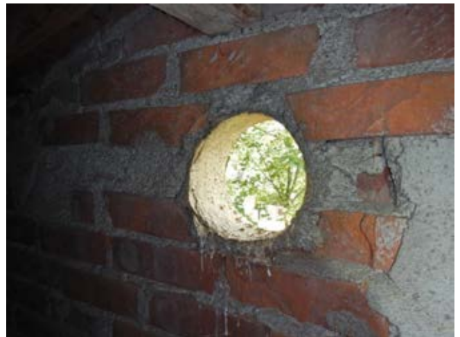
Kuva 34. Yläpohja tuulettuu päädyn aukoista ja räystäältä. Päädyn aukossa ei ole ritilää tai verkkoa, joten eläimillä on vapaa kulku yläpohjaan.
