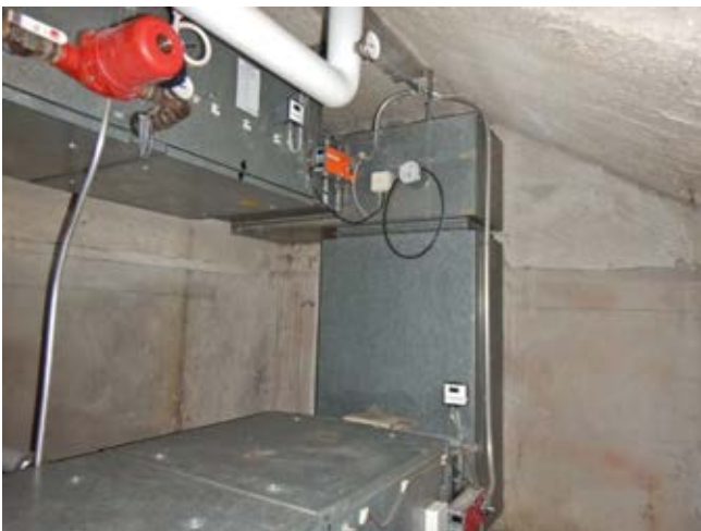
Kuva 56. Raitisilmakammio sisäkautta. TK-1 alhaalla, lattialla ja TK-2 katossa
