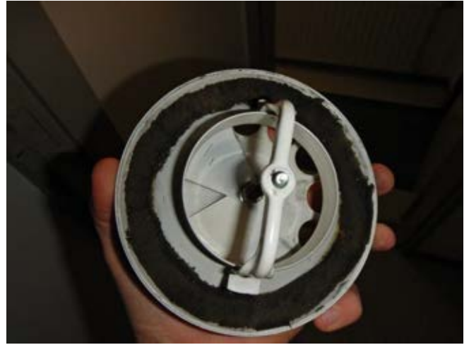
Kuva 75. Tuloilman pääte-elinventtiin tiiviste likaantunut ja hapertunut tilassa B001
