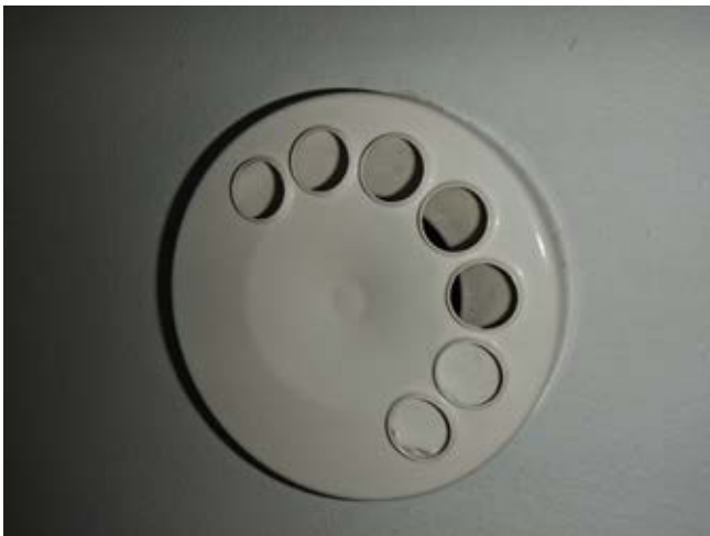
Kuva 48. Asuinhuoneiden tuloilman pääte-elin
