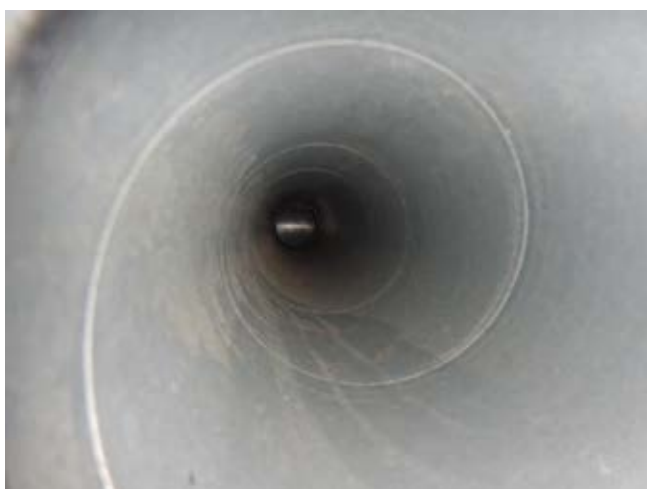
Kuva 80. pölykertymää B003 tuloilmakanavassa
