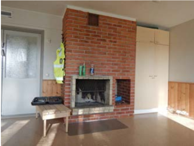
Kuva 50. Vanha painovoimainen poistoilmaventtiili 0. krs takahuoneessa
