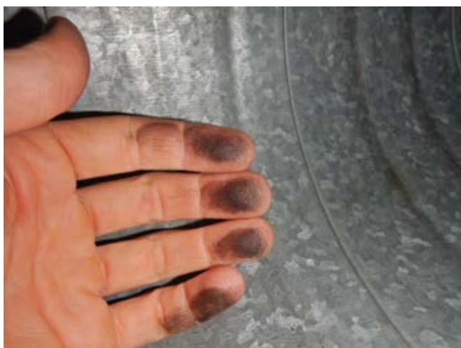
Kuva 84. TK-2 1. kerroksen käytävän runkokanavan sisäpinnassa on mustaa likaa
