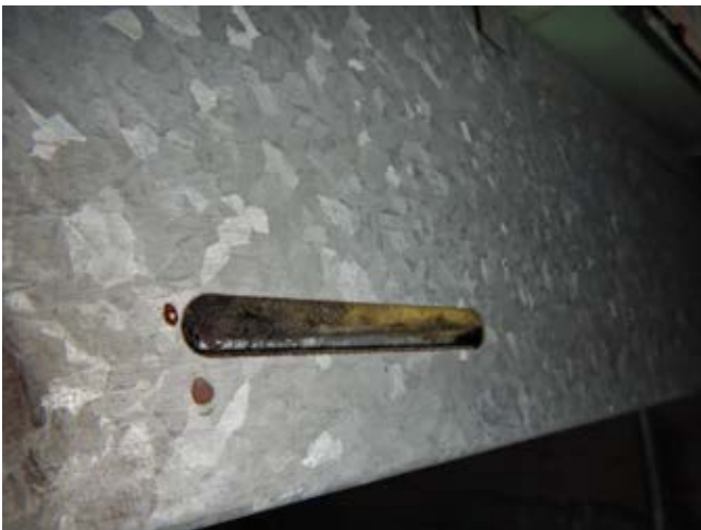
Kuva 68. TK-2 puhaltimen luukkujen kiinnikkeiden koloissa on paljasta mineraalivillaa näkyvillä
