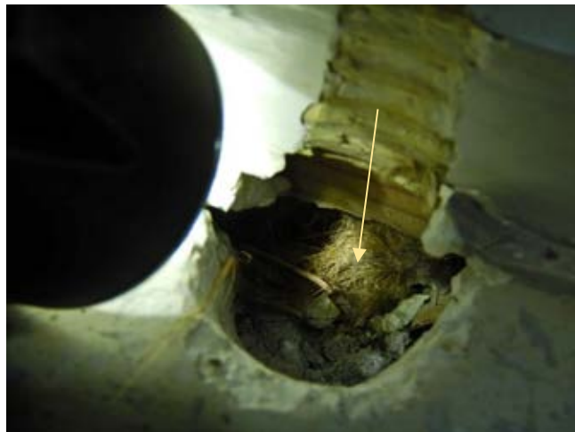
Kuva 20. Ikkunan alakarmin ja ulkoseinän liitoksessa on pellavarivetilke
