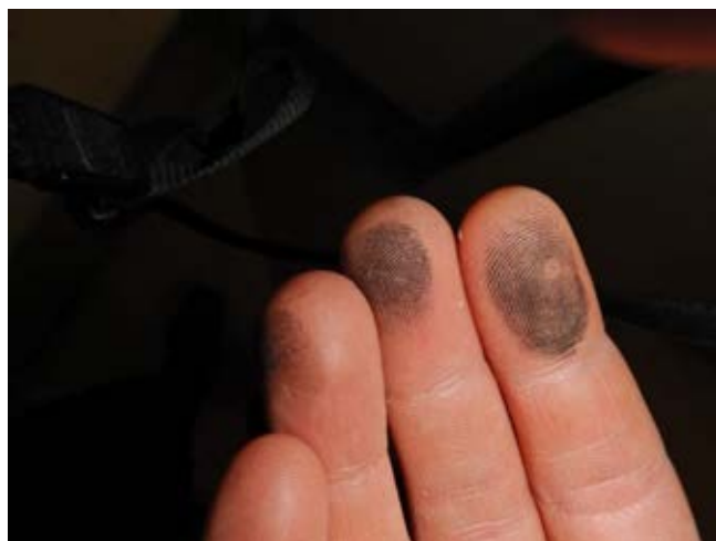
Kuva 73. TK-1 0. kerroksen runkokanavassa kanavan sisäpinnassa oli mustaa likaa, joka irtoaa sormeen pyyhkäistäessä.
