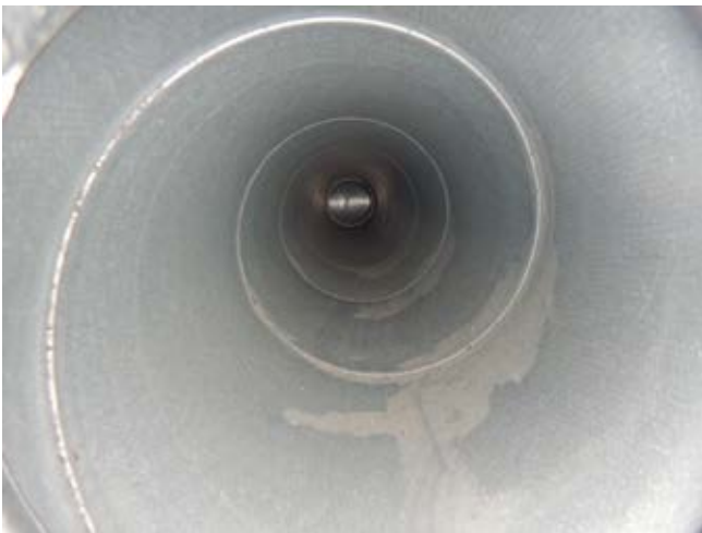
Kuva 76. Kuivia vesijälkiä ja pölykertymää B001 tuloilmakanavassa
