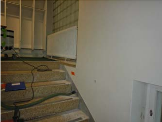
Kuva 15. Ulkoseinän rakenneavaus RA9 porrashuoneessa
