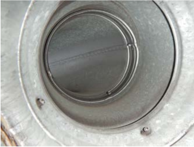
Kuva 74. Pölykertymää ja tummaa likaa TK-1 tuloilman runkokanavassa 0. kerroksessa
