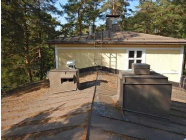
Kuva 46. Poistoilmapuhaltimet sijaitsevat vesikatolla.
