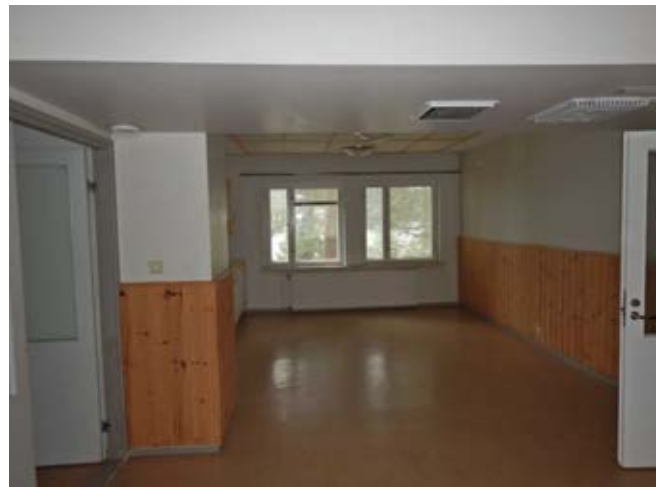
Kuva 53. Uusia 2000-luvulla asennettuja tuloilman päätelaitteita 1. kerroksen ryhmähuoneessa
