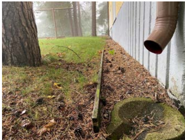
Kuva 2. Takapihalla sadevedet ohjataan betonikouruihin. Vierustäytöt ovat osin hienojakoista kiviainesta, perusmuurissa on patolevyt. Maanpinnan kaato on osin rakennuksen suuntaan.
