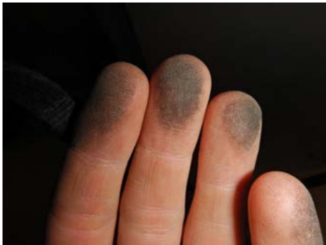
Kuva 82. TK-1 1. kerroksen runkokanavan sisäpinnassa on mustaa likaa
