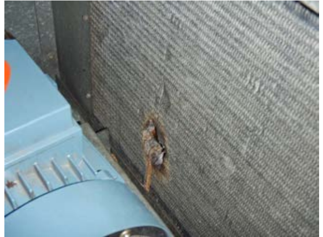
Kuva 59. TK-1 Lämmityspatterin puhaltimen puoleisissa säleissä oli reikä. Patterissa on mahdollisesti korjattu vuoto-kohta.
