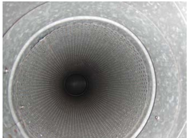
Kuva 69. Äänenvaimennin TK-1 jälkeisessä kanavistossa B010 kohdalla
