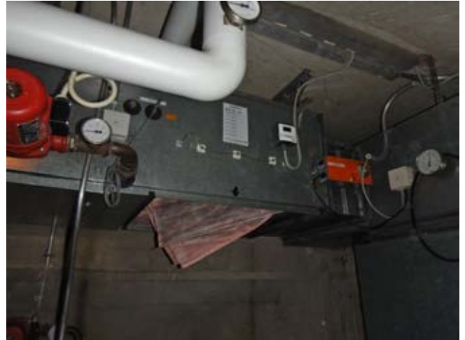
Kuva 63. Yleiskuvat TK-2. Kone sijaitsee tilan katossa ja sen luukkujen käsittely yksin on vaikeaa
