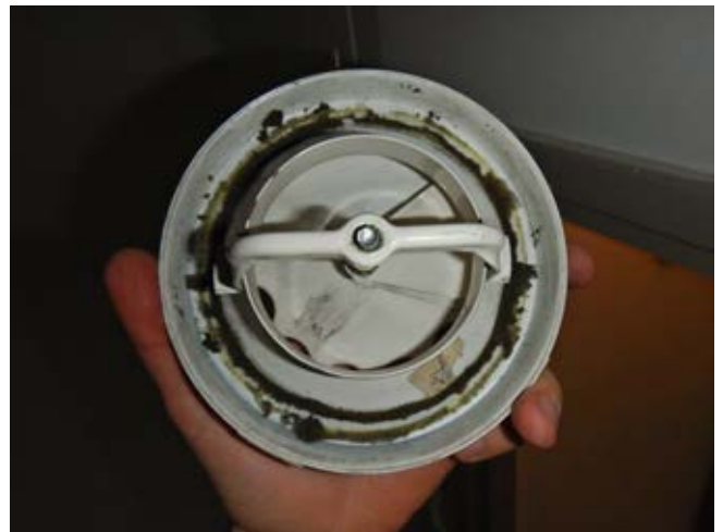
Kuva 77. Tuloilman pääte-elinventtiin tiiviste likaantunut ja hapertunut tilassa B002
