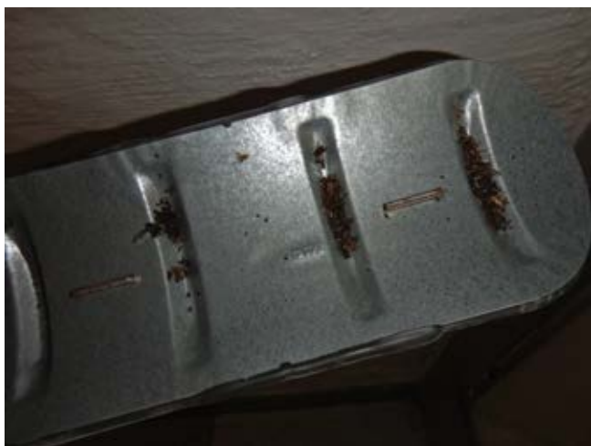
Kuva 72. TK-1 tuloilman runkokanavassa oli kuolleita hyönteisiä
