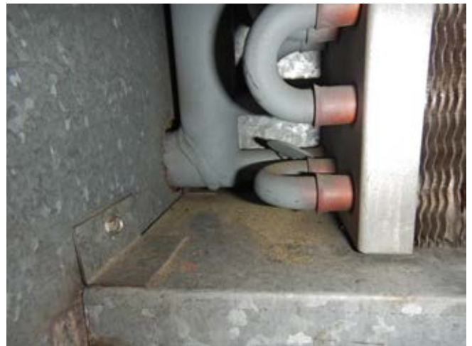
Kuva 65. TK-2 lämmityspatterin sivuissa oli pölykertymää
