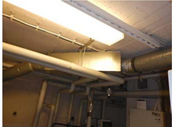
Kuva 51. Vanha painovoimainen poistoilmaventtiili 0. krs lämmönjakohuoneessa
