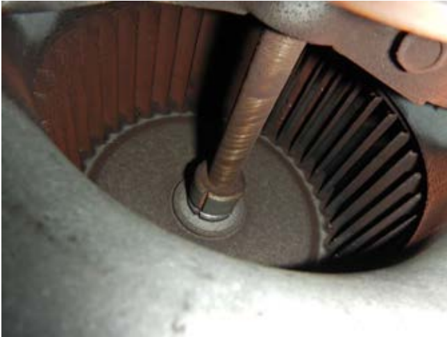
Kuva 66. TK-2 puhaltimen sisällä ruostetta ja pölykertymää
