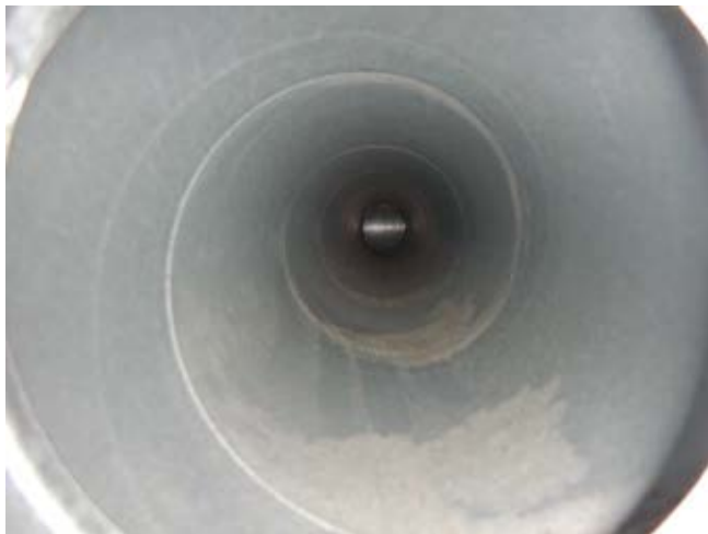
Kuva 78. Kuivia vesijälkiä ja pölykertymää B002 tuloilmakanavassa
