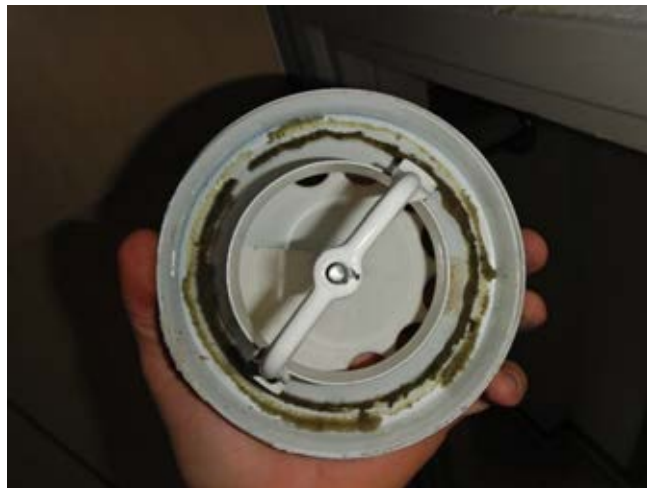
Kuva 79. Tuloilman pääte-elinventtiin tiiviste likaantunut ja hapertunut tilassa B003
