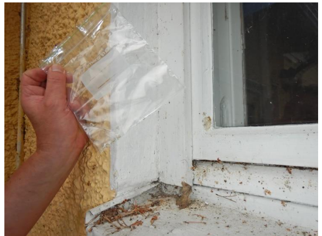
Kuva 10. ASB.09 Ikkunakitti ei sisällä asbestia
