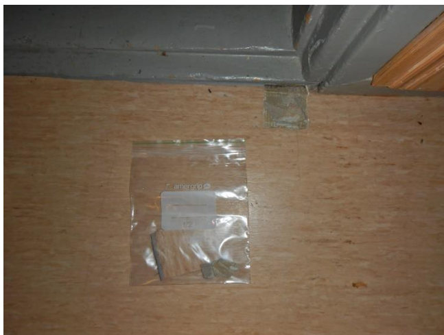
Kuva 11. ASB.10 Ruoka- ja päivähuoneen B106, lattian vaaleanruskea muovimatto + kiinnitysliima + tasoite ei sisällä asbestia
