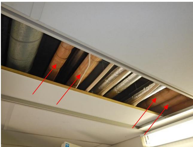
Kuva 1. Käytävän B006 alakaton yläpuolella olevat aaltopahvieristeet sisältävät asbestia ( ASB.02 ).
