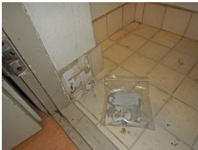
Kuva 12. ASB.11 Siivouskomeron B116, lattian 100*100 mm lattialaatta + kiinnitysliasti + saumalaasti ei sisällä asbestia
