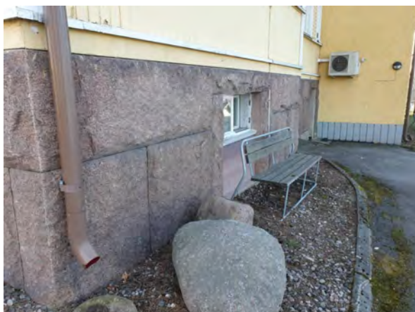
1. Katoilta tuleva vesi valuu rakennuksen vierustalla olevaan betonikouruun.
