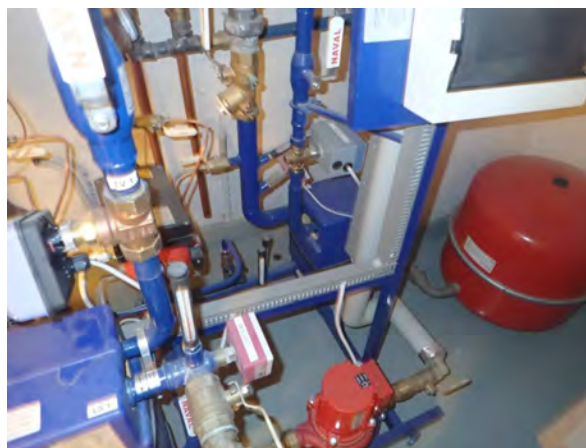
80. Lämmityksen ja lämpimän käyttöveden säätöventtiilit ovat arviolta vuodelta 2008.
