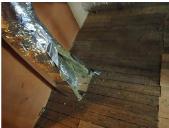
133. Yläpohjan ilmanvaihtokanavat on eristetty asiallisesti. Hieman eristeitä irronnut.
