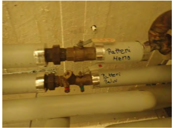
77. Linjasäätöventtiili oletettavasti vuodelta 1988.
