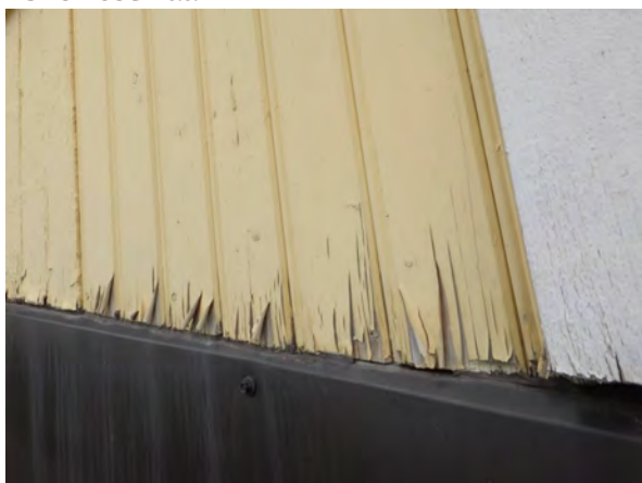
31. Puuverhouksessa on havaittavissa paikoin maalipinnan varioita
