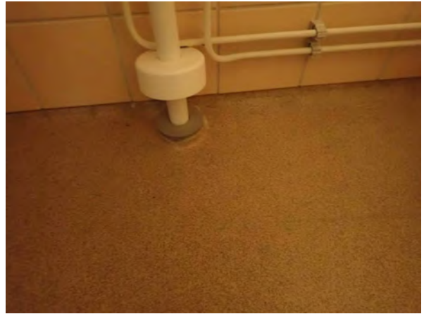
96. Viemärit ovat muovia.
