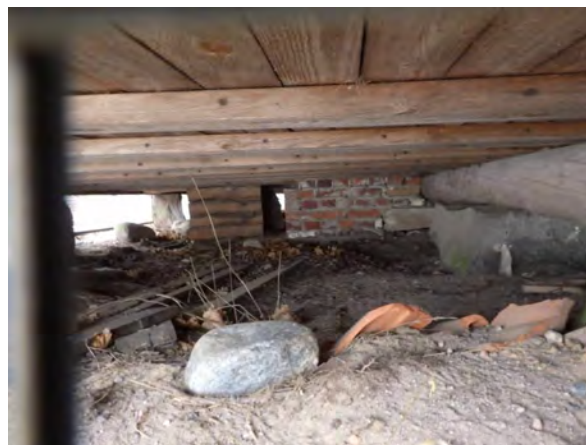
28. Alapohjassa on rakennusjätettä, lehtiä, maapinta ei ole tasainen.
