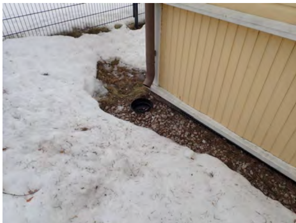
101. Osin sadevesille on lisätty rännikaivot, johtamisesta ei varmuutta.
