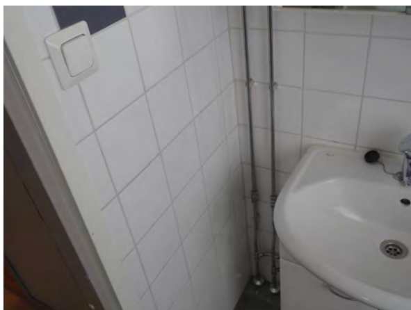
90. Vesijohdot ovat uusittuja.
