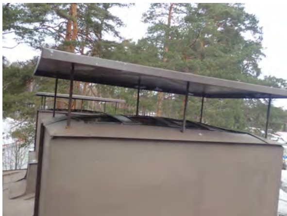
116. Painovoimaisen ilmanvaihdon hormipiipun päissä on sadehatut.
