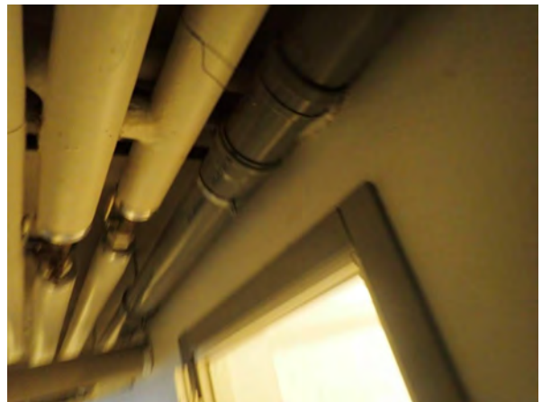
98. Viemärit ovat muovia.
