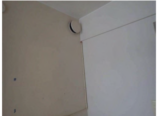
130. Lautasventtiili painovoimaisen ilmanvaihdon alueella.
