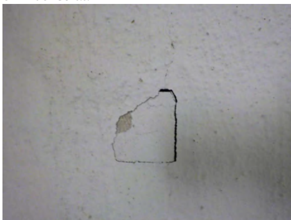
56. Kellaritilan seiniin on jäänyt muottilaudotusta.
