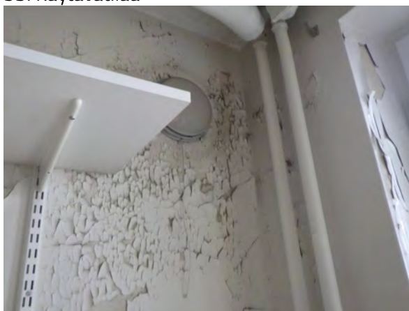
55. Maalipinta hilseilee paikoin alakerran tiloissa.
