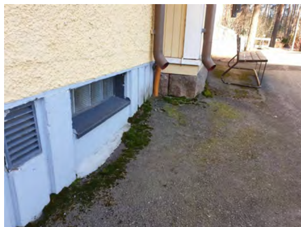
2. Katolta tuleva vesi valuu rakennuksen vierustalle.
