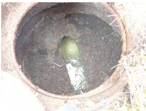
93. Tarkastuskaivo lähellä saunarakennusta, ei liittymää saunan suuntaan.
