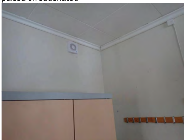
118. 2.kerroksessa myös yksi melko uusi kanavapuhallin poistolle omalla säätimellä.
