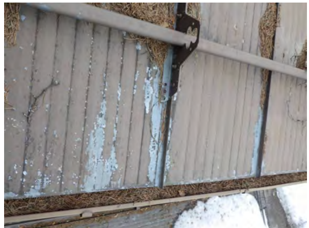
46. Räystäskouruissa ja katon pinnalla on paikoin runsaasti neulasia.
