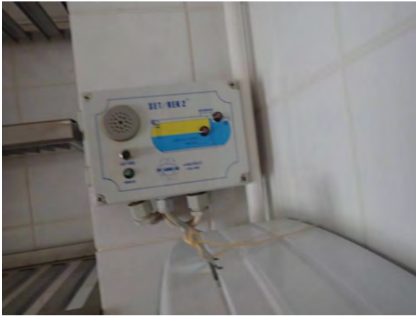
95. Keittiön rasvanerotuskaivon hälytysjärjestelmä.
