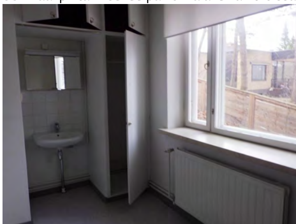
57. Tarkastetussa huoneessa oli muista huoneista poikkeava tuoksu. Lavuaarin alla havaittiin kohonnutta kostusrasitusta. Tila sijaitsee -58 luvulla rakennetussa osassa.
