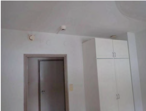
127. Poistoventtiilinä lautasventtiili koneellisen ilmanvaihdon alueella.
