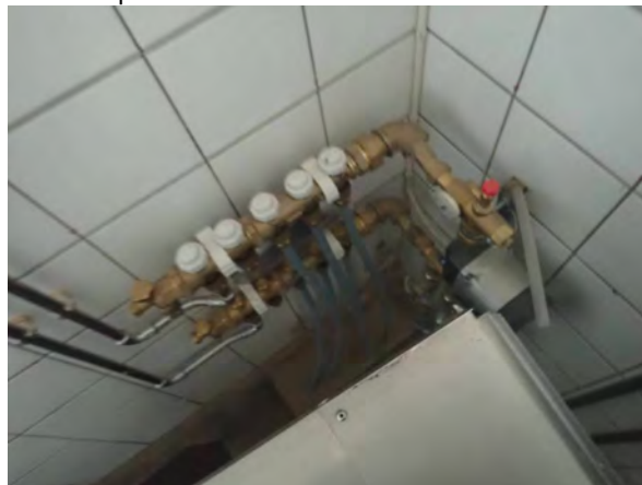
73. Vesikiertoiset lattialämmitykset saunatiloissa.
