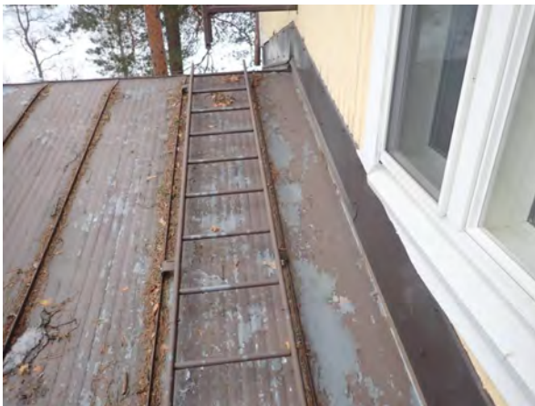
45. Katon maalipinta on osin vaurioitunut
