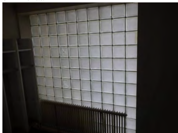
36. Lasitiili-ikkunassa on rikkoutuneita lasia.
