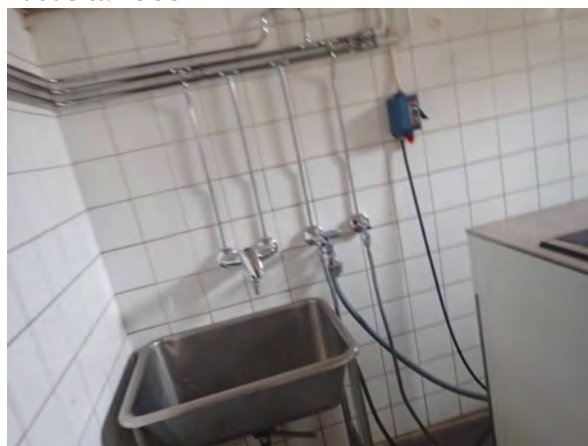
91. Vesijohdot ovat uusittuja.
