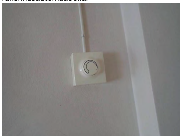
122. Tyristori-säädin, oletettavasti ohjataan pienempää huippuimuria PK-1.
