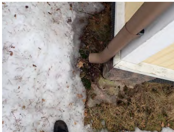
102. Osin sadevedet johdetaan maahan/loiskekivillä kauemmas rakennuksesta.
