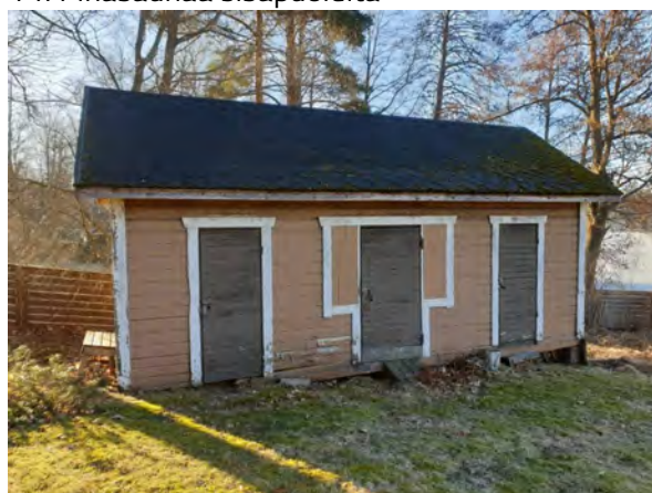
16. Varstorakennus on huonokuntoinen
