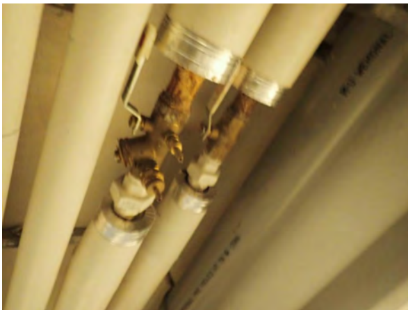
78. Linjasäätöventtiili oletettavasti vuodelta 1988.
