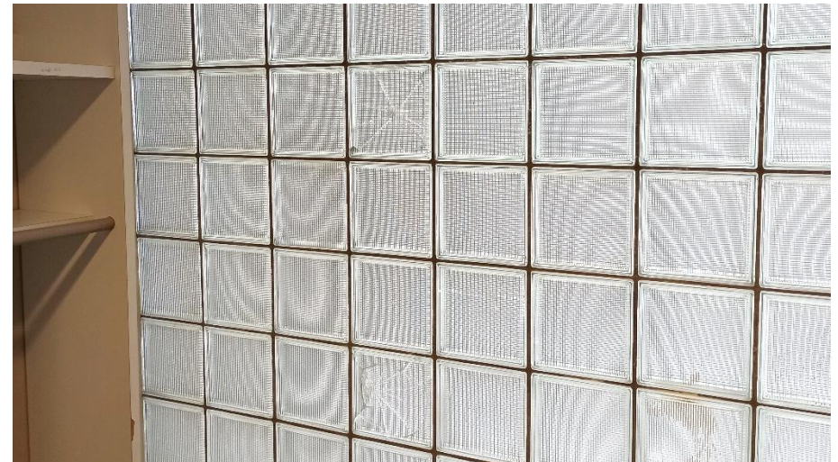
Kuvat 174 ja 175: Porrashuoneen suuri lasitiili-ikkuna tuo tilaan epäsuoraa valoa ja on tyypillinen 1950-luvun ratkaisu. Osa tiilistä on murtunut. Kuvat: FCG, 2023.
