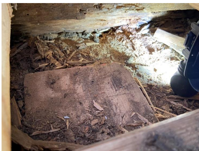
Kuva 8. Pukuhuoneen nurkassa hirren sisäpinnassa lahovaurioita alapohjarakenteen eristetilan tasolla
