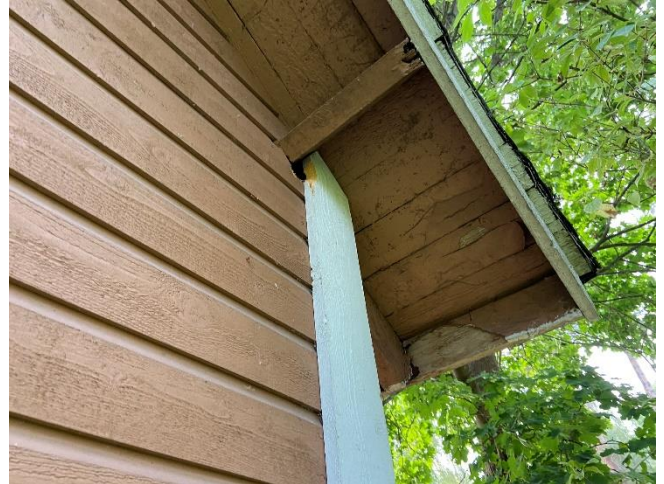
Kuva 12. Räystään alapinnan maalipinnassa vaurioita ja räystään puurungon päässä vähäistä lahovauriota
