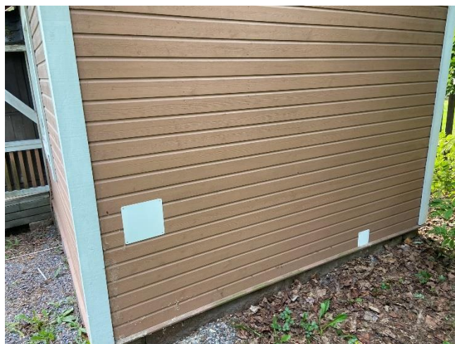
Kuva 2. Sokkelikorkeus matala, maanpinta kaataa kohti rakennusta.
