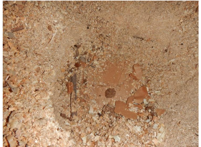
Kuva 16. Purueriste oli aistinvaraisesti hyväkuntoista.
