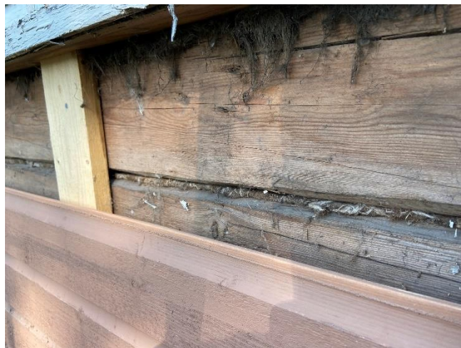
Kuva 7. Rakenneavaus ikkunan alapuolelle, lautakoolaus uudempi lauta
