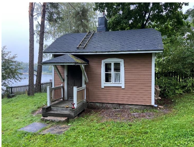
Kuva 1. Rakennuksessa ei ole sadevesikouruja eikä syöksytoria
