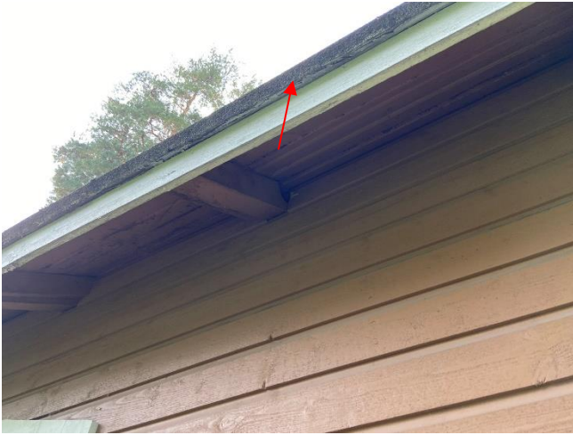
Kuva 3. ASB3 vesikaton vanha alushuopa ei sisällä asbestia
