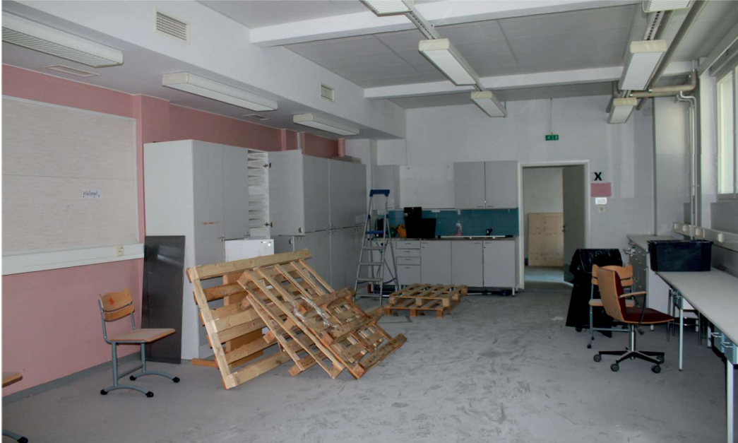
Kuva 116. Käsiöluokka uusittiin vuonna 2001 tulipalon vuoksi. Kuva vuodelta 2025. Kuva H&M Arkkitechdit
