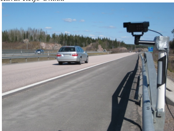
Kamera kiinnitettynä sumupaalun pidikkeeseen
