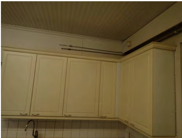
70. Vesijohdot ovat kuparia.
