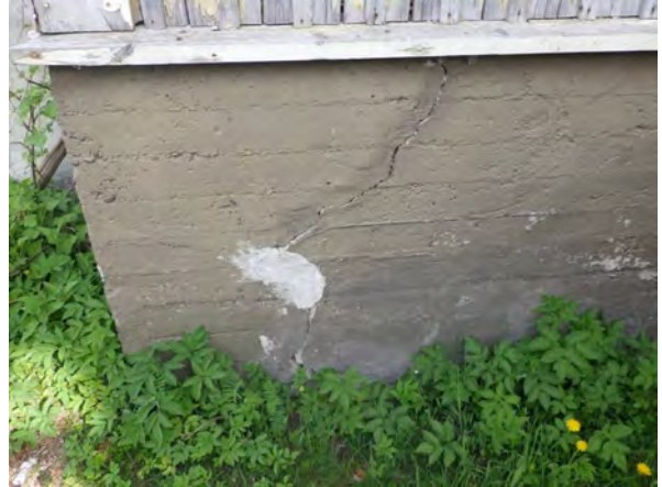
18. Sokkelissa on halkeamia.
