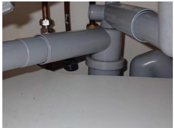
84. Keittiöhanan pesukoneen liitos olisi hyvä tulpata.
