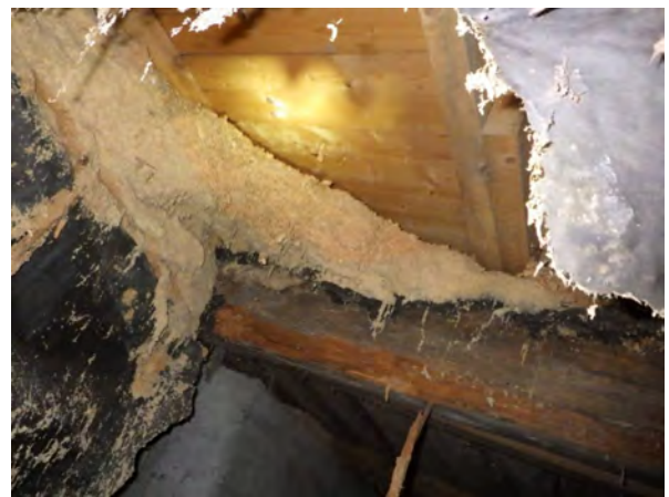
22. Alapohja on pururakenteinen, purua on paikon pudonnut maahan.
