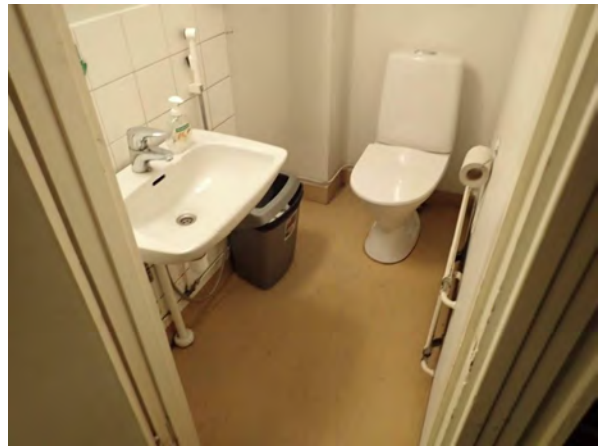
71. Vesijohtoja alakerran wc:llä.
