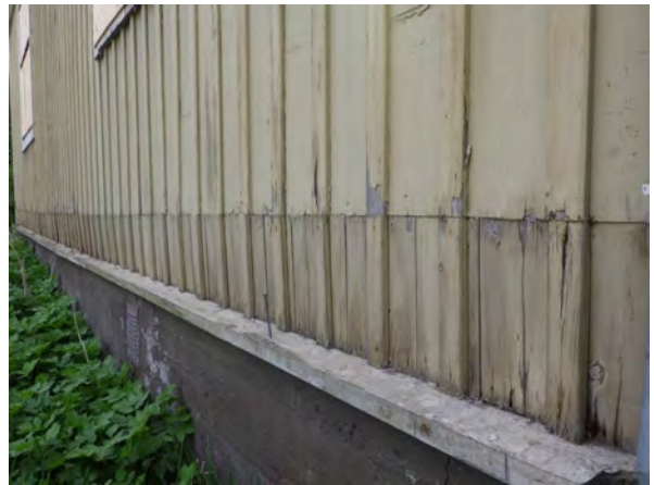
30. Ulkoseinässä on näkyvillä aiemmin korjattuja kohtia.
