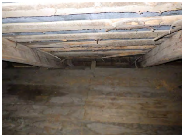
46. Kattorakenteet, peltikaton alla harvalaudoitus ei aluskatetta.
