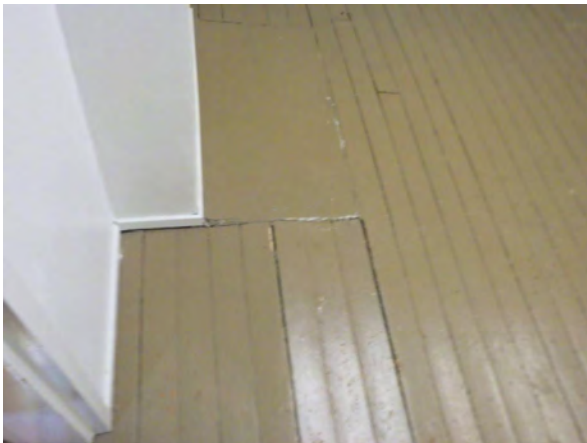
27. Yläkerran lattia on paikoin painunut.
