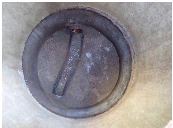
78. Pihan tarkastuskaivolta lähtevä viemäri on muovia.
