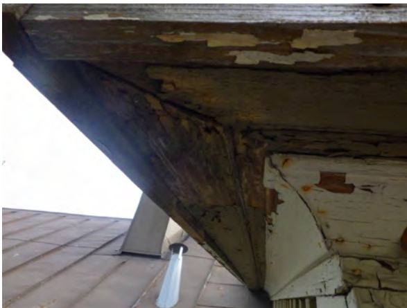
45. Rästyslaudoitus on paikoin huonossa kunnossa.
