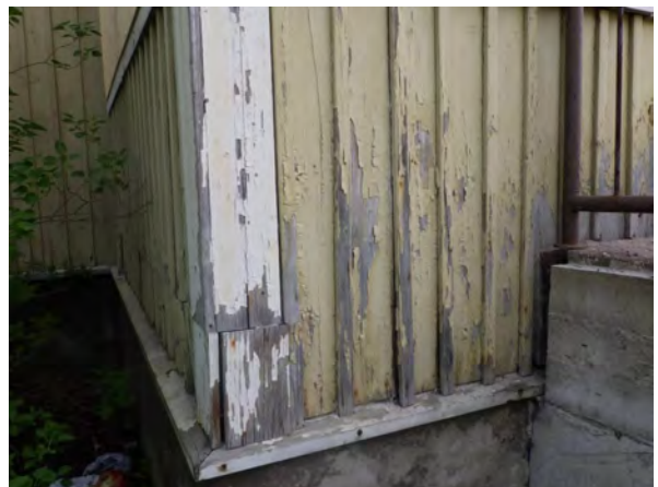
32. Ulkoseinien lautaverhous on paikoin huonossa kunnossa.
