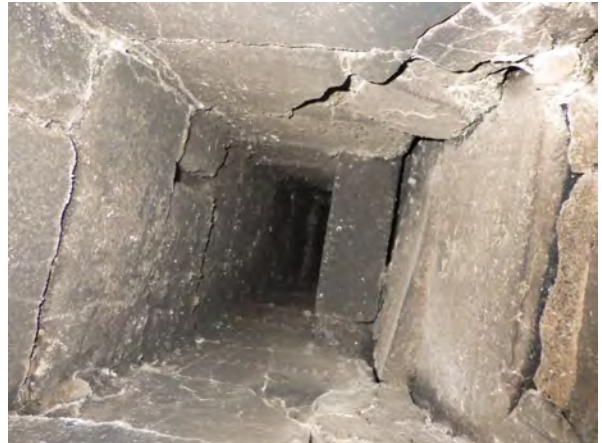
26. Rakennuksen hormia, hormissa näkyy halkeamia.
