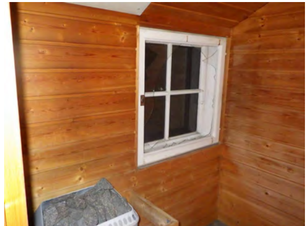
36. Saunan ikkuna oli rikottu
