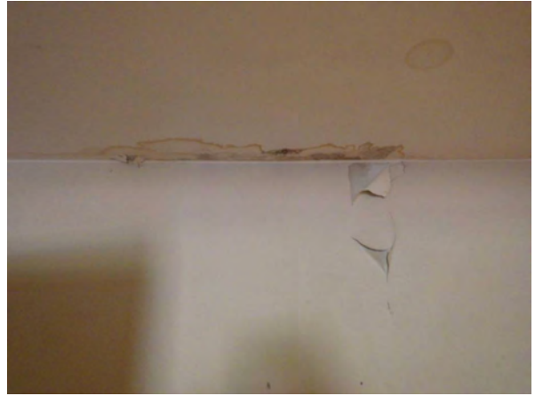
2. Kosteusvaurioihin liittyvät havainnot
