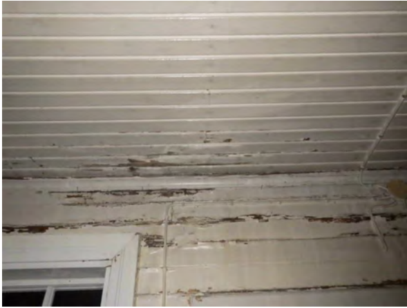
1. Kosteusvaurioihin liittyvät havainnot
