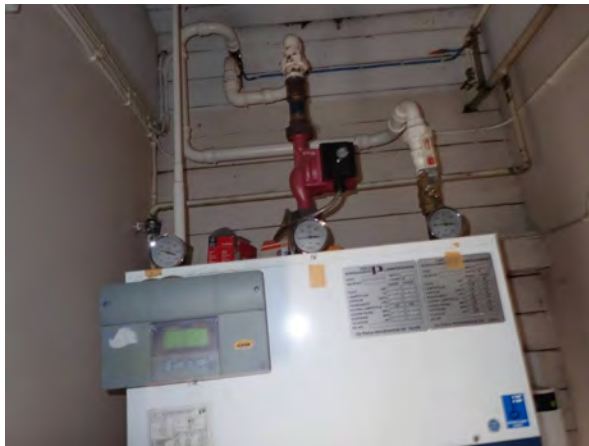
60. Kiertovesipumppu. Vain menopuolella sulku, paluupuolella ei havaittu linjasäätöventtiiliä.
