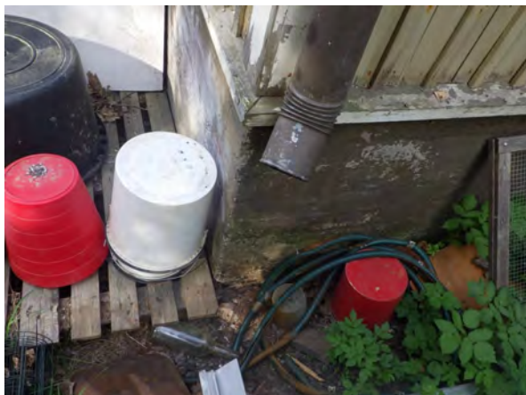
5. Katolta tulevat vedet ohjautuvat rakennuksen vierustalle.
