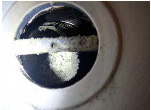
89. Alakerran wc:n kanava ei ole hyvin kiinni päätelaitteessa. Kanavassa merkittävää pölykertymää.
