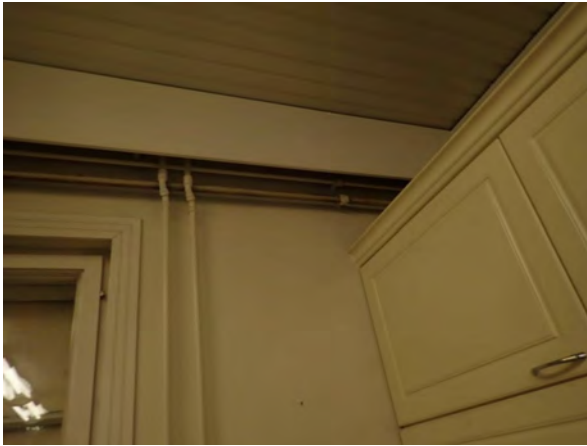
66. Lämpölinjat ovat pinta-asenteisina.
