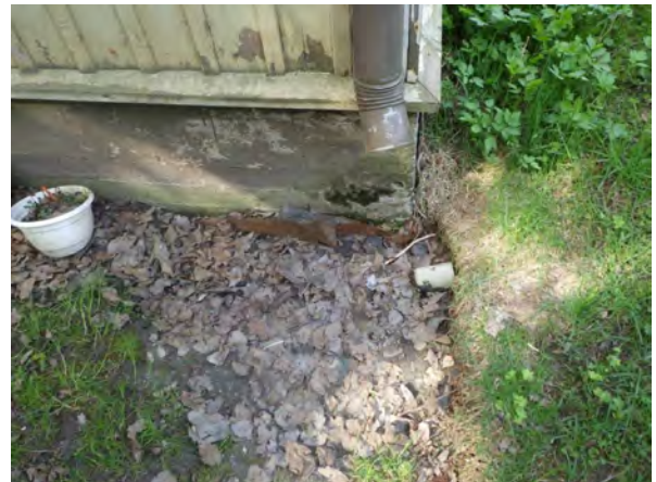
4. Katolta tulevat vedet ohjautuvat rakennuksen vierustalle.
