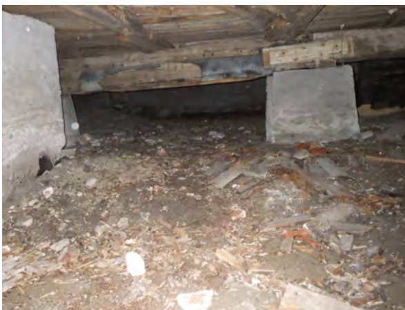
21. Alapohjassa on paljon rakennusjätettä ja lahonnutta puuta.
