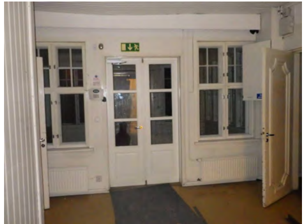
38. Sisäovet ovat pääosin hyvässä kunnossa.
