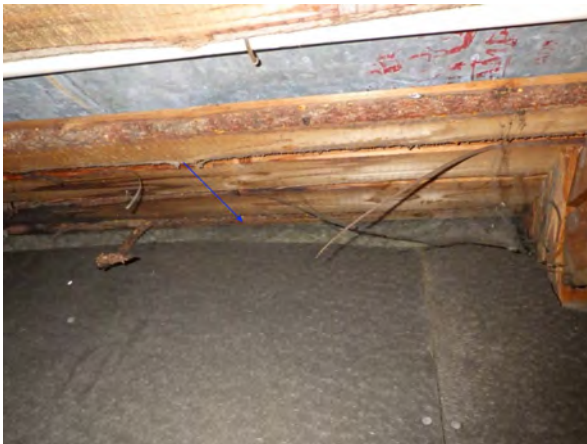
47. Eristettyjen huonetilojen ja katon tuuletusväli oli paikoin tukittu.
