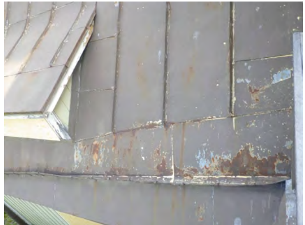
44. Vesikatossa on ruostetta.
