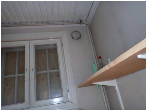
93. Yksi korvausilmaventtiili havaittiin alakerrassa.
