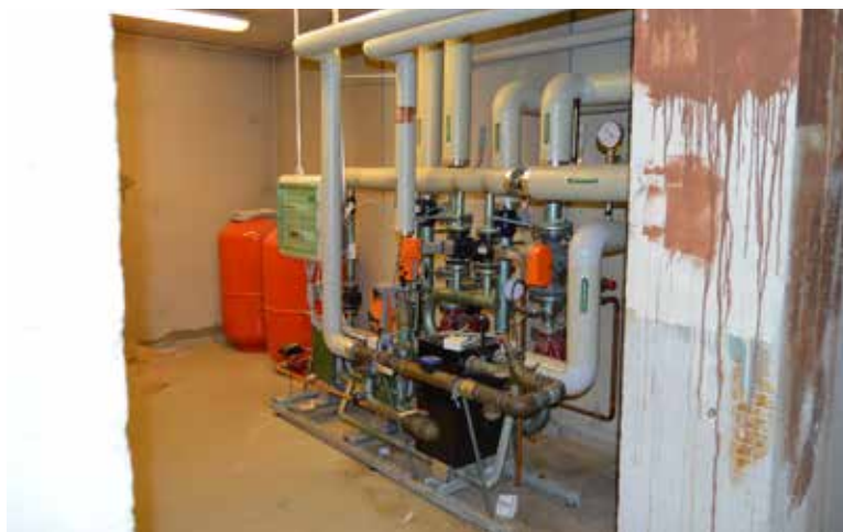
Kuva 39. Lämmönjakohuone rakennuksessa C.
