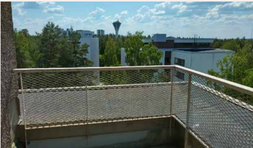
Kuva 32. Tomutusparveke poistunut B-rakennuksen katolta, näkymä C-talon saunan vilvoitteluparvekkeelta.
